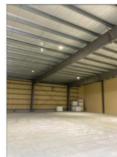
倉庫内LED化
